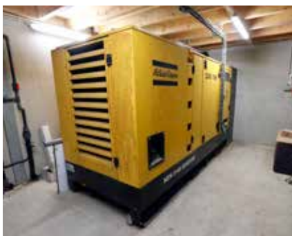
De plaatsing en aansluiting van het noodaggregaat zijn een schoolvoorbeeld. Het bedrijf heeft twee aggregaten.
